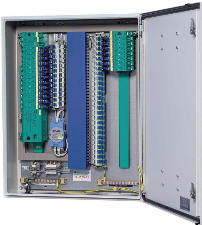
Bild 4: Auch zugehörige Betriebsmittel werden künftig durch Ausführungen des Schutzniveaus ic ersetzt
