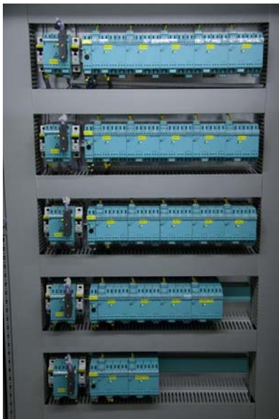
Bild 3: Ordnung und Platz im Leittechnikschrank mit dem Segmentkoppler Sk2. Je Segment werden bis zu 16 Feldgeräte, die in der Zone 1 montiert sind angeschlossen.
