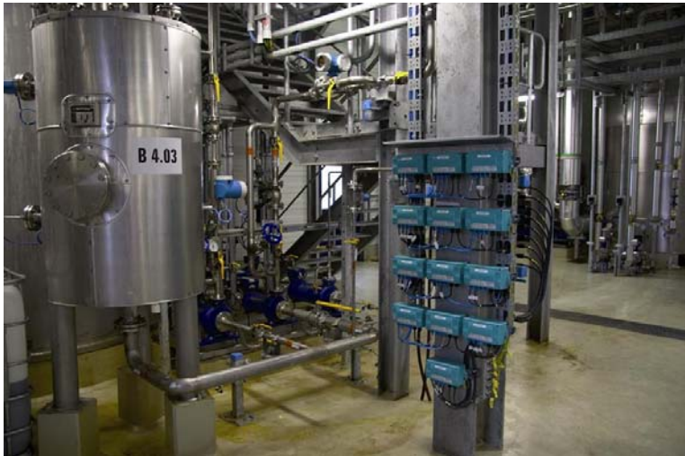
Bild 2: Eigensicherheit im Feld realisiert. Feldbusbarrieren begrenzen die über die Hauptleitung übertragene Energie in der Nähe der Feldgeräte. Maximale Kabelwege und Anzahl Feldgeräte wird so erreicht.
