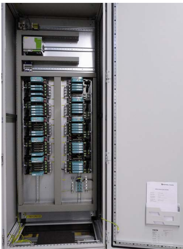
Bild 1: Feldbus Power Hub im Schaltschrank
