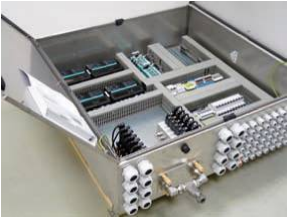
Bild 2: Feldverteilerstation mit Segment Protector, Ventilschaltung und Schwachstrom-Ventilen
