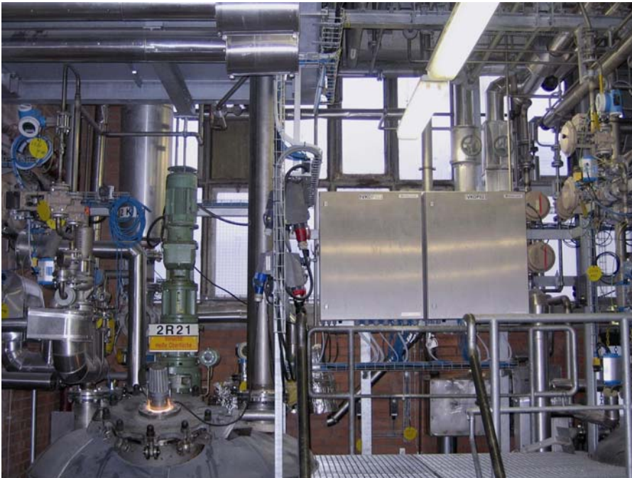
Bild 1: Teilanlage mit zugehörigem Schaltkasten
