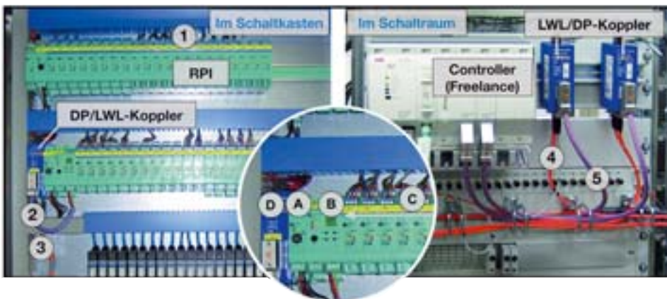
Bild 3: Schaltkasten (links) und zugehörige Komponenten im Schaltraum (rechts). Dazwischen die Komponenten des RPI-Systems im Schaltkasten: 1 Verbindungen zwischen RPI und den Feldgeräten, 2 Profibus DP zwischen RPI und DP/LWL-Koppler, 3 Ausgang DP/LWL-Koppler zum Schaltraum (Lichtleiter), 4 Eingang in den LWL/DP-Koppler im Schaltraum vom Schalt-schrank, 5 Ausgang aus dem LWL-DP-Koppler zum Controller (Profibus DP), A Einspeisebaustein mit Busabgriff, B Profibus-DP-Buskoppler, C E/A-Module, D DP/LWL-Koppler
