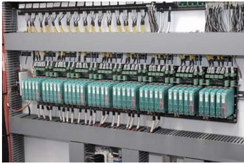
Bild 2: FieldConnex Power Hubs, die Feldbusspeisung ist mit Diagnose der Feldbusphysik: Advanced Diagnostics ausgerüstet. Es meldet online und in Echtzeit Störungen in der Installation und ermöglicht so die proaktive Wartung der Feldbusinstallation selbst.
