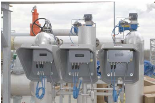
Bild 3: Feldbusbarrieren mit eigensicheren Anschlüssen sind in der Nähe der Feldgeräte installiert. Der Zugang zu den Instrumenten im laufenden Betrieb ist gewährleistet.
